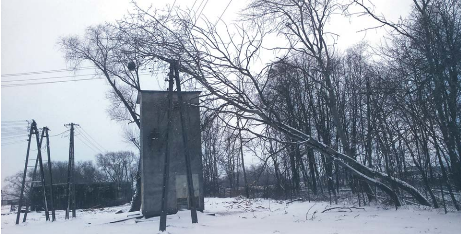
Według energetyków drzewo przewróciło się na wewnętrzną sieć energetyczną, za którą odpowiada jej właściciel i to on powinien zająć się usunięciem powalonego drzewa
