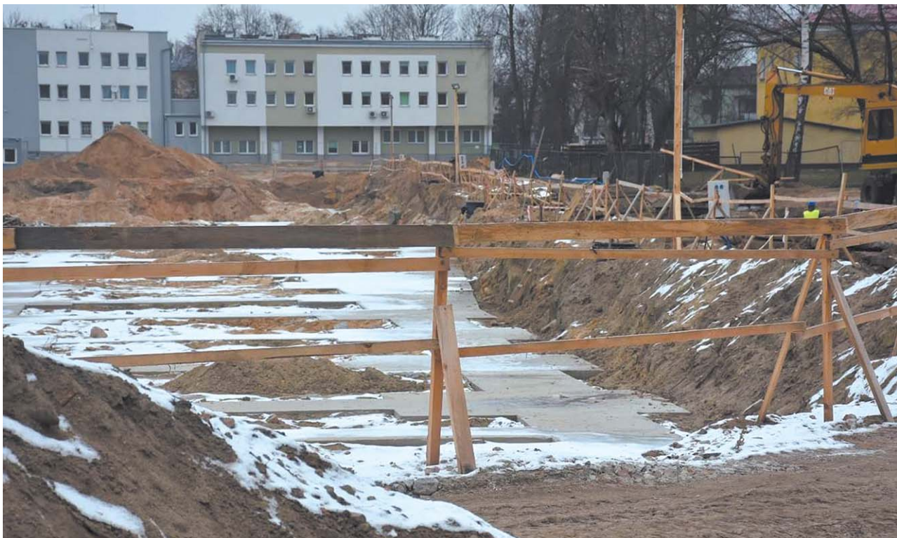
Wykonawca, z którym miasto rozwiązało umowę, pozostawił po sobie rozgrzebany plac zamiast stadionu
