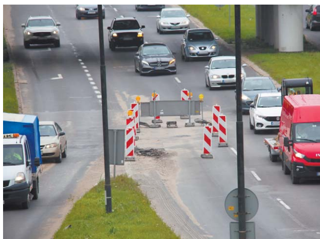
Na al. Witosa poważnie uszkodzona została kanalizacja
