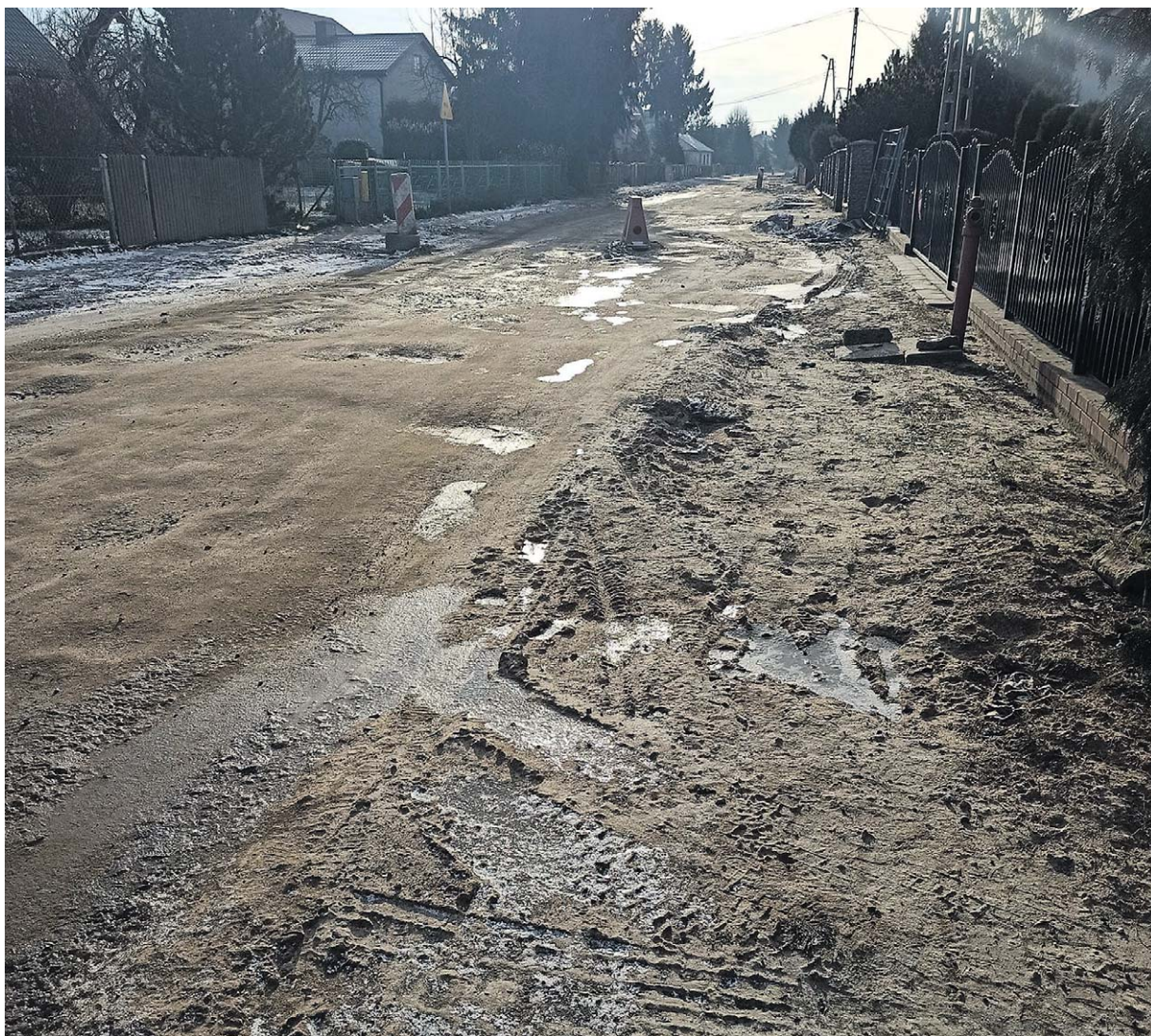
Tak wygląda droga w Zabielu
