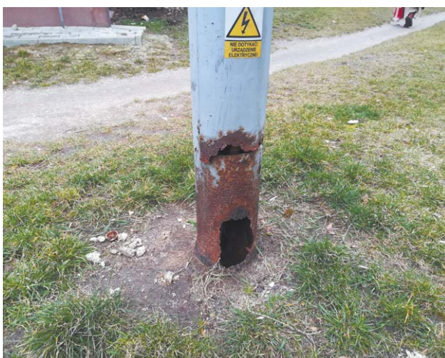
– Tak naprawdę to strach chodzić koło tych latarni – mówią mieszkańcy
