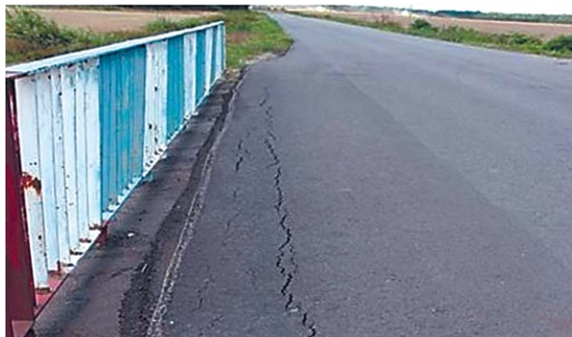
Skutki braku właściwego nadzoru inwestorskiego. Droga powiatowa nr1615L na odcinku Podedwórze – Zgliszcze w powiecie parczewskim
