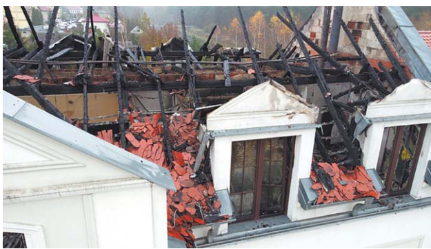
Dach domu pielgrzyna po pożarze
