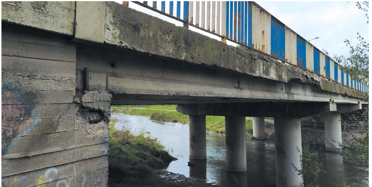
Most na Bystrzycy w ul. Żeglarskiej. Przetarg na zaprojektowanie nowej konstrukcji został ogłoszony przez Zarząd Dróg i Mostów dwa dni temu
