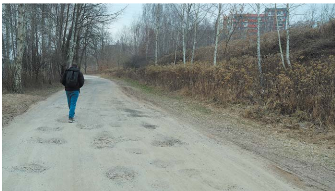
Fragment ul. Węglinek prowadzący z os. Poręba w kierunku przystanku kolejowego Lublin Zachodni to wyboje i dziury
