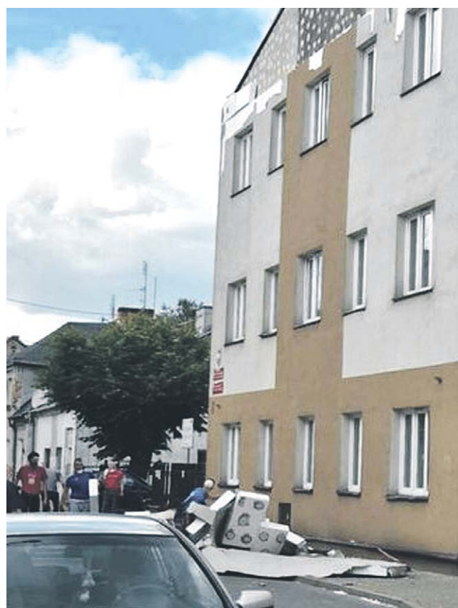
Szczęście w nieszczęściu – w chwili oderwania się elewacji nie było przechodniów
