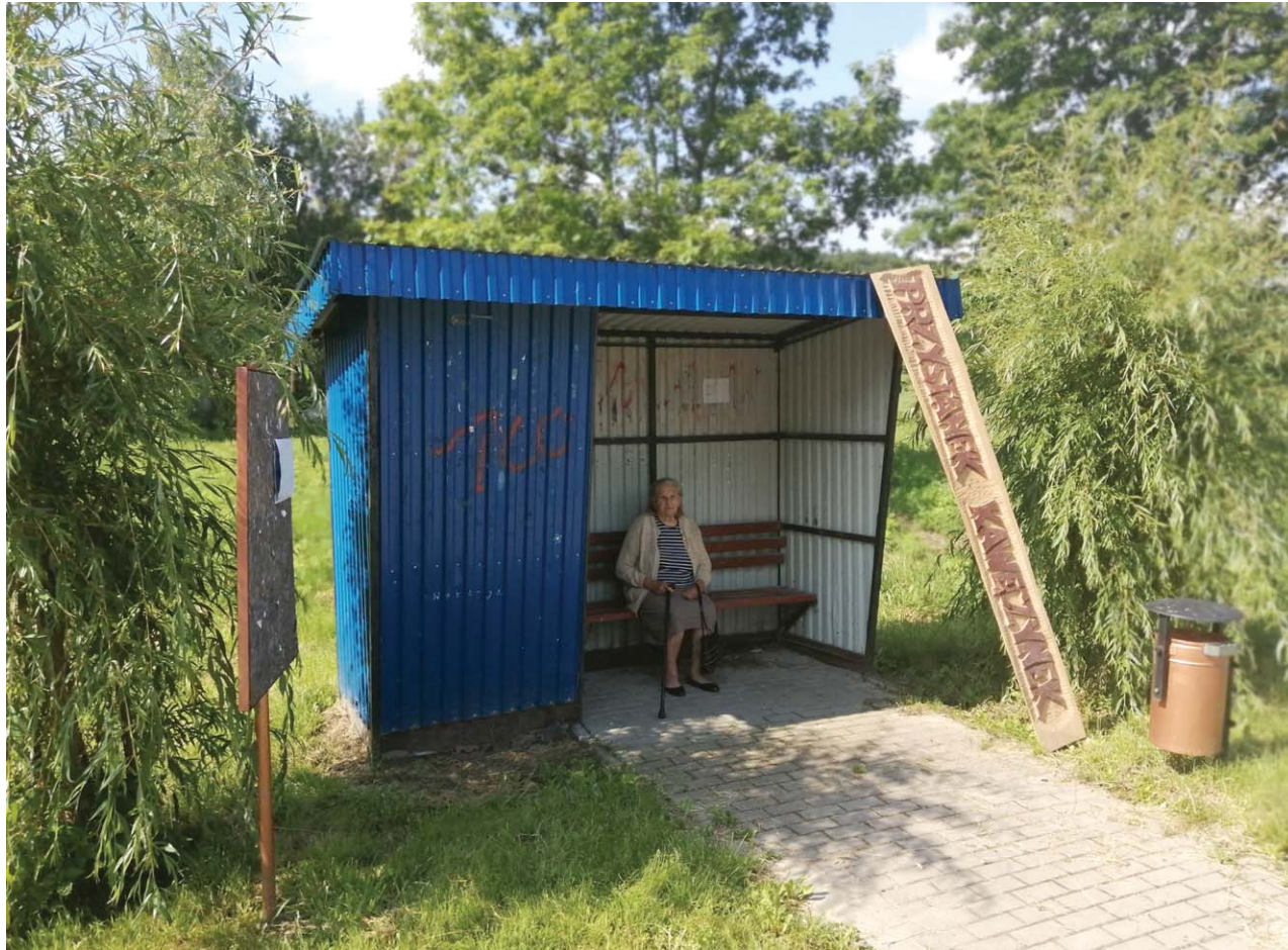
Mieszkańcy przystanek w Kawęczynku ironicznie nazywają Manhattanem, bo to centrum ich towarzyskich spotkań. Mają nadzieję, że gmina odnowi konstrukcję a wówczas zamontują stylowy, drewniany napis
