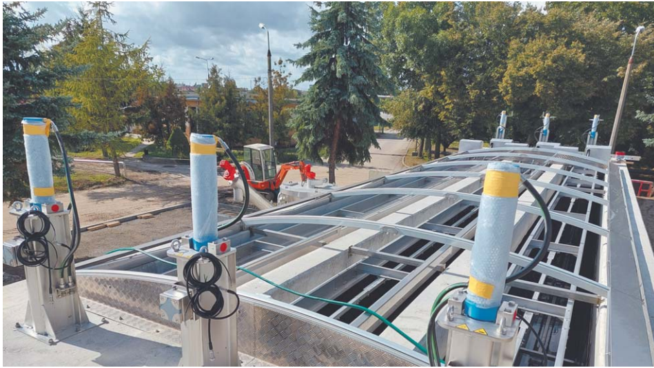
Fot. 1 Piaskownik na terenie oczyszczalni ścieków w Łukowie
