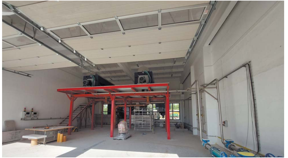
Fot. 2 Pomieszczenie odwadniania osadu na terenie oczyszczalni ścieków w Łukowie
