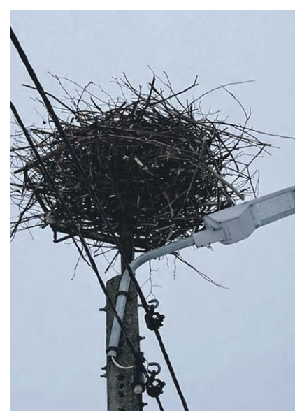
Gniazdo bocianów na infrastrukturze drogowej
