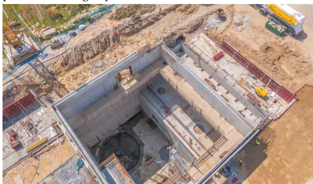
Zbiornik pomieści 8 tysięcy metrów sześciennych wody
