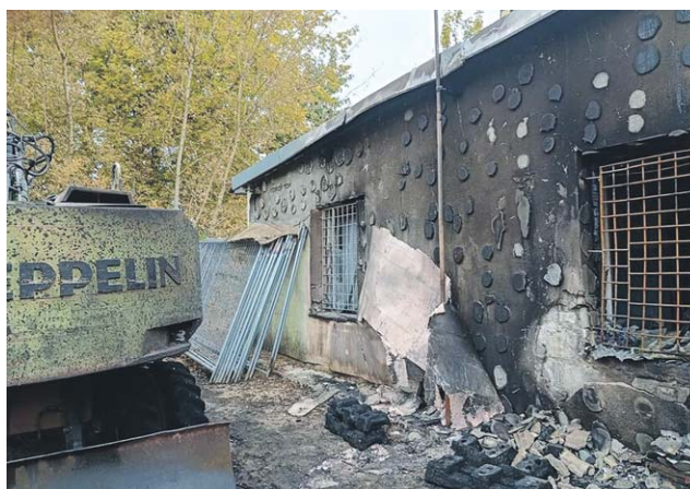
Pożar strawił budynek gospodarczy, a także zniszczył kuchnię i stołówkę
