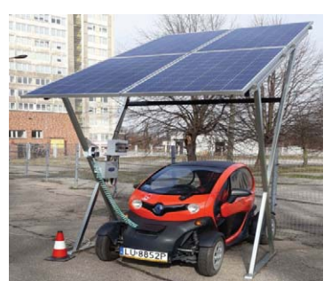
Rys. 3. Ładowanie pojazdu Renault Twizy z carportu fotowoltaicznego o mocy szczytowej 1 kWp
