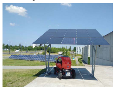
Rys. 2. Ładowanie pojazdu Renault Twizy z carportu fotowoltaicznego o mocy szczytowej 3 kWp
