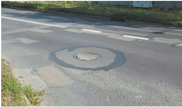
Ulica Sidorska wymaga remontu
