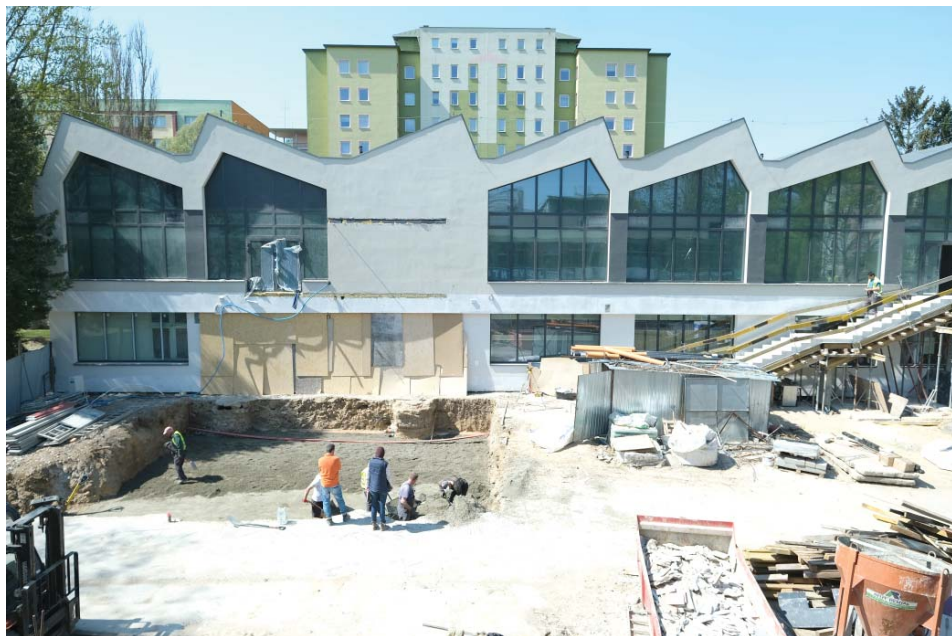
Schody prowadzące do stołówki zostały rozebrane ze względu na zły stan techniczny. Wkrótce będą odbudowane
