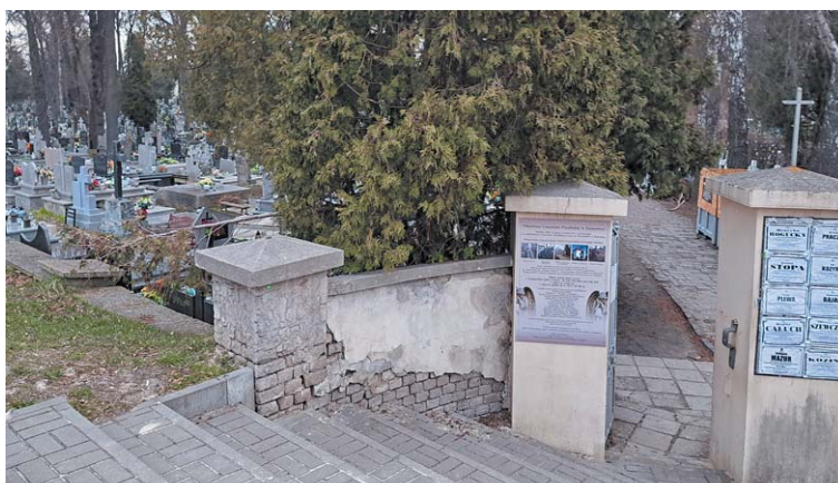
Jednym z priorytetowych zadań do wykonania jest remont bramy wejściowej i schodów przy niej, a także odnowienie ogrodzenia, które po budowie wiaduktu w 1979 roku stanowi ono mur oporowy dla chodnika i ulicy, a przez to obecnie grozi zawaleniem
