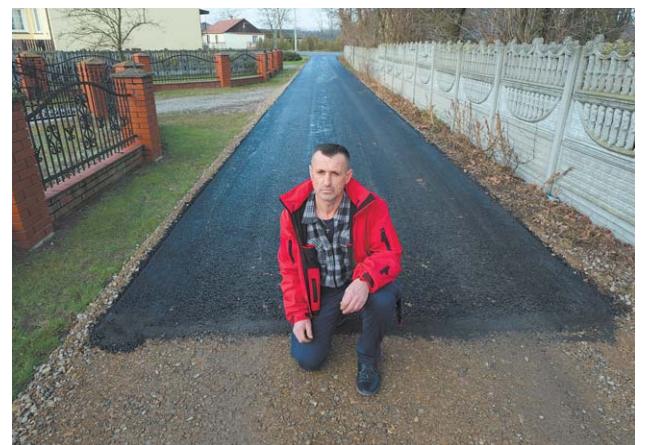
Robotnicy zrobili tylko część drogi i odjechali – mówi Paweł Ciężczyk, mieszkaniec Zagórza
