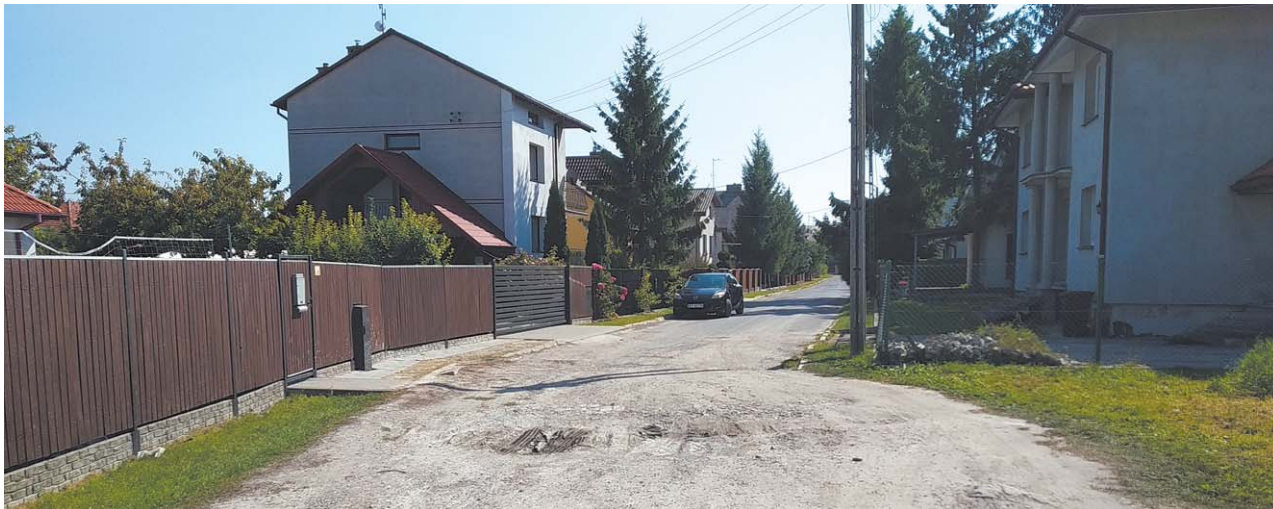
Na ul. Narcyzowej w Chełmie nie ma oznakowania ostrzegającego o tym, że zaraz kończy się asfaltowa nawierzchnia
