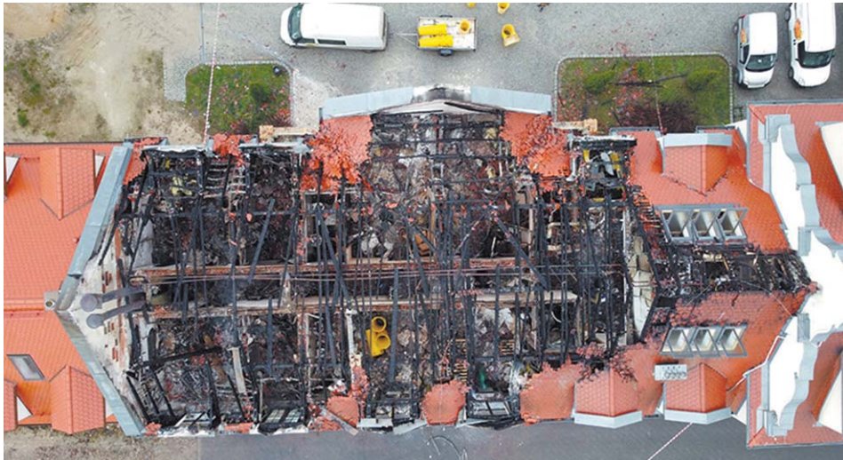
Tak wyglądał dach Domu Pielgrzyma po pożarze
