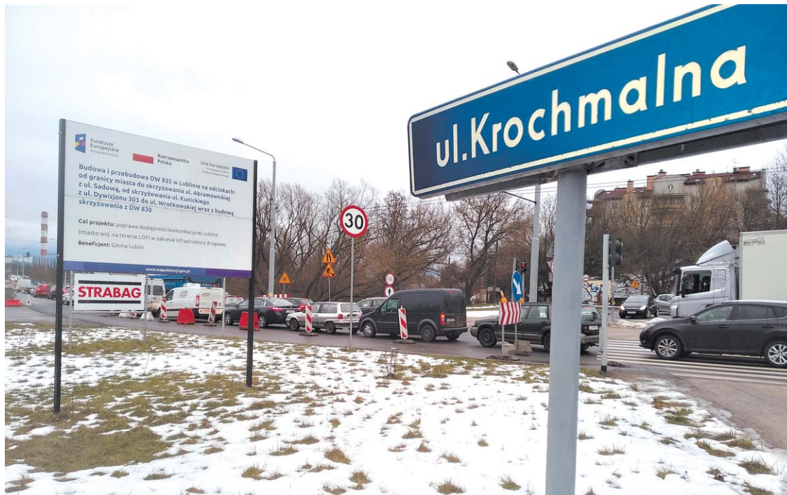
Okazuje się, że kierowców wpuszczono na drogę, która nie miała jeszcze części warstw konstrukcyjnych
