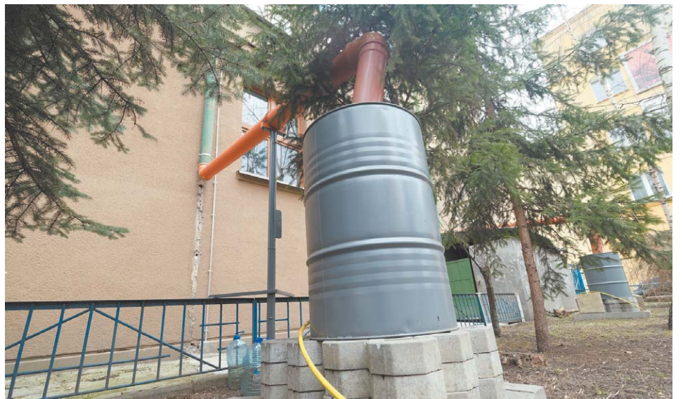
Instalacja do zbierania deszczówki przy Szkole Podstawowej nr 23 w Lublinie
