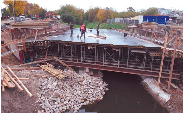
Dziś zamiast nowej przeprawy przez rzekę jest wielka wyrwa. Wybetonowane są zaledwie przyczółki mostu
