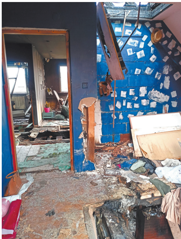
To, co zostało po pożarze nie nadawało się do rozbudowy. Dom trzeba było rozebrać
