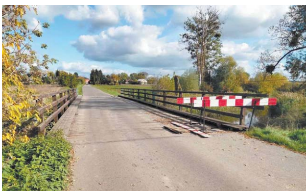
Stary, drewniany most w Brodicy ma już ponad 20 lat. Był w przeszłości remontowany, ale po prostu nadaje się do wymiany. Zanim powstanie nowy, trzeba go jednak doprowadzić do stanu używalności
