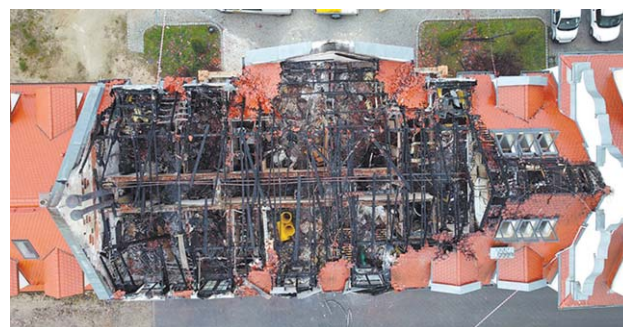
Po pożarze obiekt trzeba odbudować w całości
