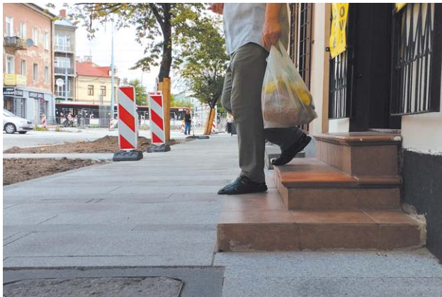
Miasto nie zdecydowało się na ułatwienie dostępu do sklepów i punktów usługowych wzdłuż ul. 1 Maja. Wciąż będzie się do nich wchodzić po schodkach FOT. DOMINIK SMAGA
