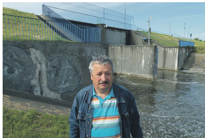
Inżynier Piotr Dańko (na tle pękającej tamy nad Zalewem Zemborzyckim) ostrzega przed niebezpieczeństwem. Urzędnicy uważają, że trzymają rękę na pulsie. Oby mieli rację
