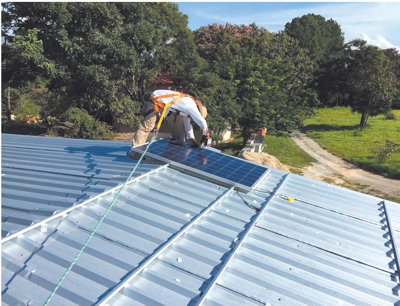
Dofinansowanie mogą otrzymać osoby fizyczne, które zdecydują się na wytwarzanie energii elektrycznej na własne potrzeby z wykorzystaniem mikroinstalacji fotowoltaicznej
