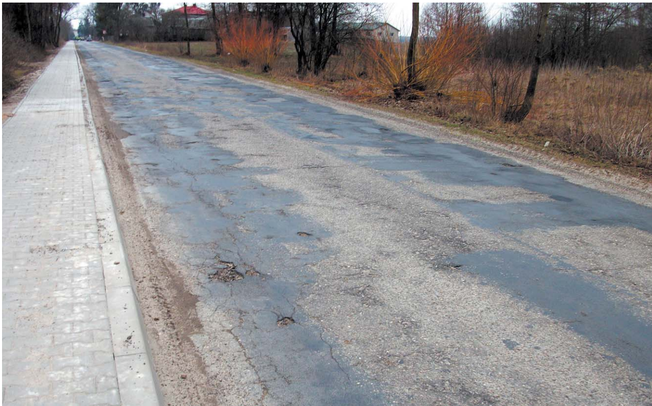
Droga w Łąkoci nie była remontowana od 30 lat
