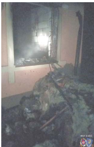
W pożarze dach nad głową straciła 5 osobowa rodzina
