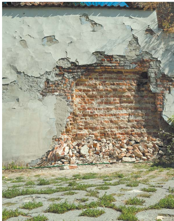
Mur oporowo-ogrodzeniowy na całej długości parkingu jest w złym stanie
