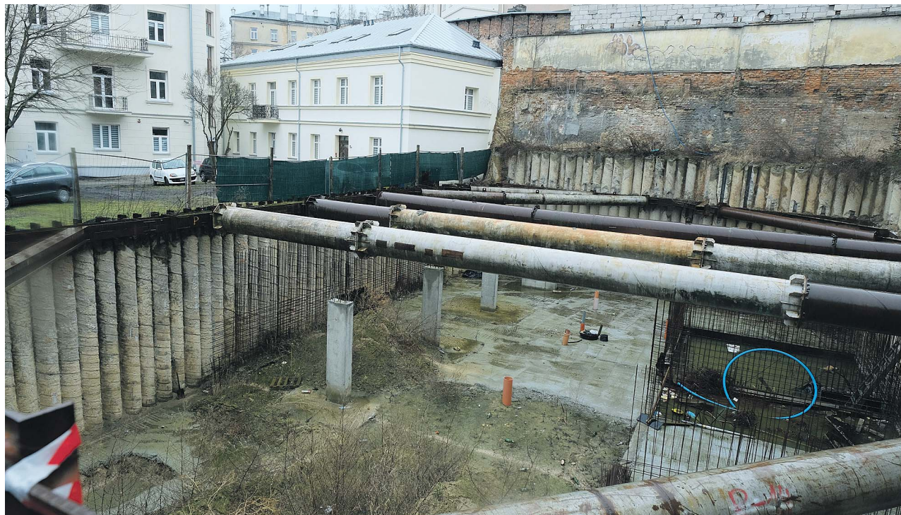
Inwestycja zatrzymała się na etapie wykopania i uzbrojenia ogromnego dołu
