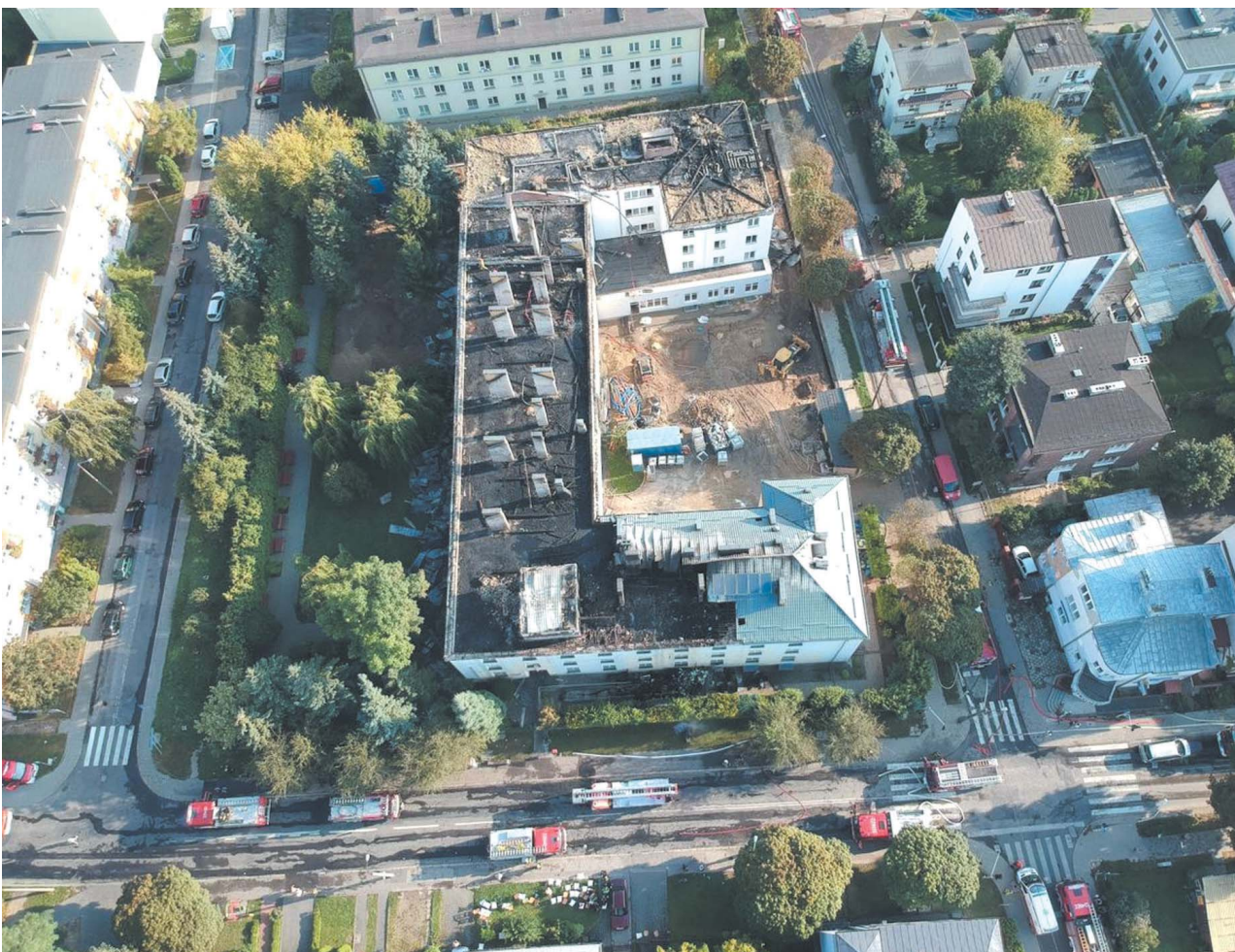
Budynek tuż po pożarze
