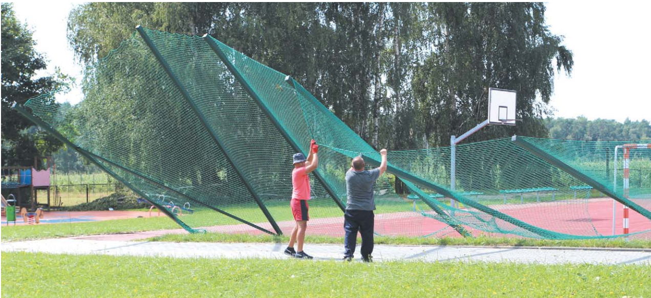
Wiatr zerwał część dachu głównego gmachu i Sali gimnastycznej. Ucierpiały też m.in. piłkochwyty przy szkolnym boisku
