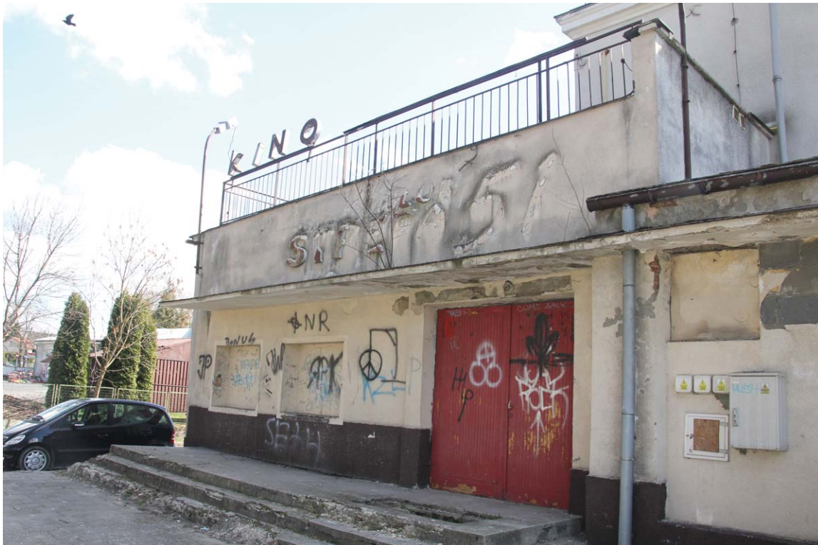
Budynek po dawnym kinie „Pola” ze względu na jego stan techniczny od lat nie jest użytkowany
