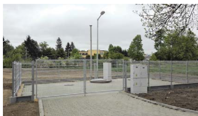
Przepompownie w osiedlu Ryccie zostały podłączone do istniejącego systemu monitoringu, dane dotyczące ich pracy oraz stanów alarmowych przesyłane są przy pomocy systemu GPRS.
