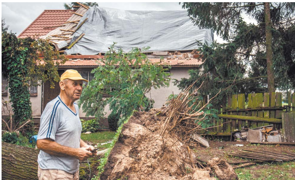
Właściciele pojechali na wakacje. Wróć do zniszczonego domu
