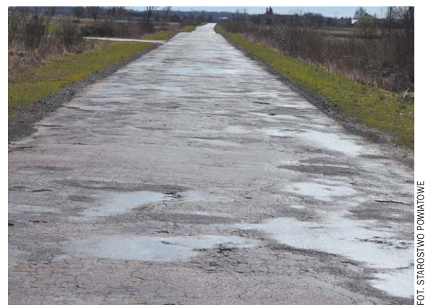
Dziś nawierzchnia drogi jest w bardzo złym stanie
