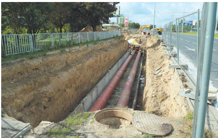
Władze Lubelskiego Przedsiębiorstwa Energetyki Ciepłej przyznają, że pandemia nie miała przełożenia na wyniki finansowe i zaplanowane inwestycje
