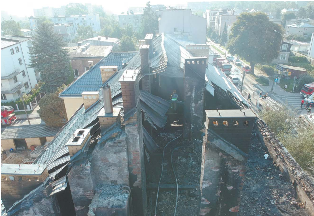
Przetarg na odtworzenie spalonego dachu powinien zostać ogłoszony jeszcze w listopadzie
