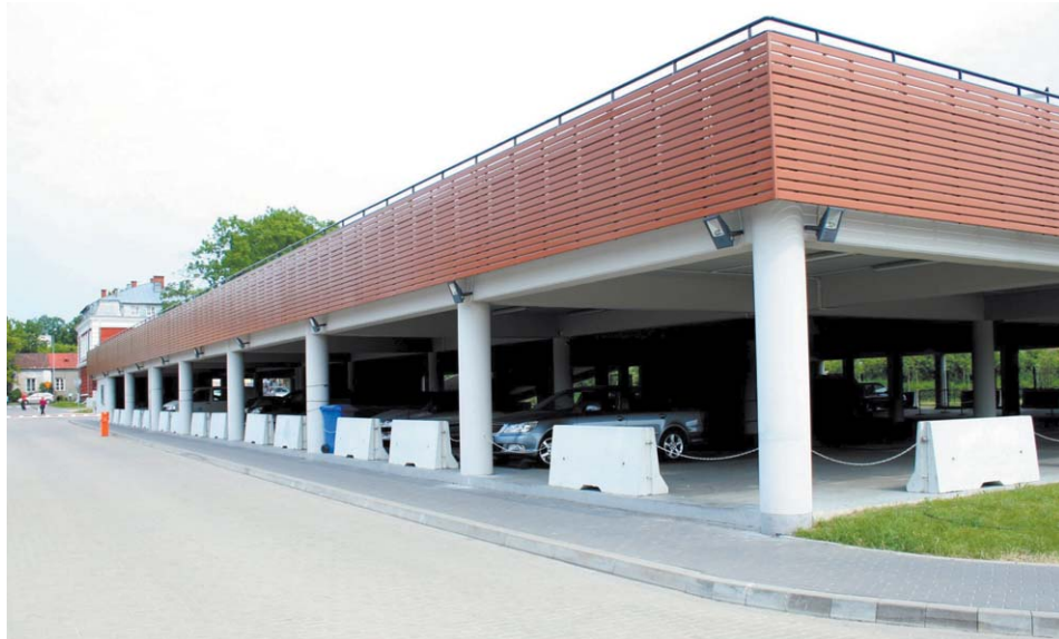
Zdaniem puławskich urzędników, budowa dwupoziomowego parkingu przy Portowej była pechowa. Sufit nadal przecieka, a pieniądze, które miały służyć do naprawy, miasto będzie musiało zwrócić wykonawcy
