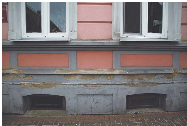
Zawilgocone mury kamienicy
