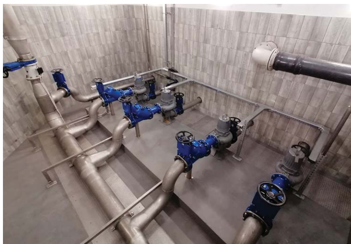
Fot. 4 Pompownia ścieków w Parku Miejskim
