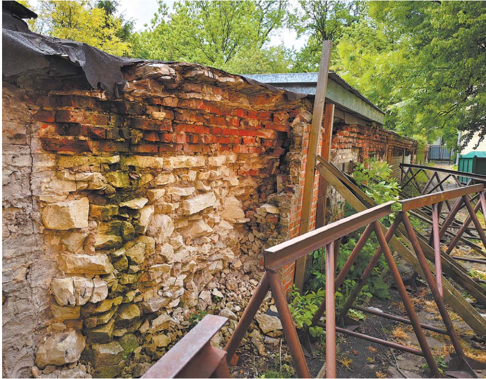
W kolejce do naprawy czeka także zabytkowy mur przy ul. Sienkiewicza 22
