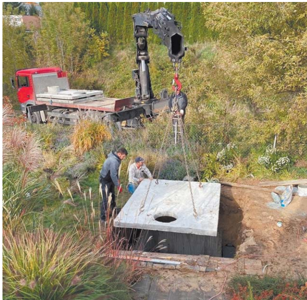
Od początku istnienia programu powstało do tej pory ponad 100 instalacji małej retencji: zbiorników podziemnych i naziemnych, studni chłonnych i oczek wodnych
