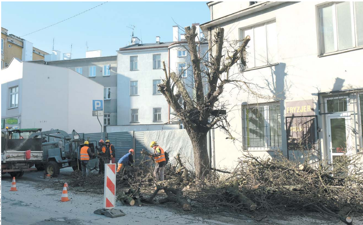
Ul. Pocztowa. Urzędnicy: Drzewo koliduje z planowanym w tym miejscu chodnikiem, zjazdem do posesji oraz budową infrastruktury oświetleniowej
