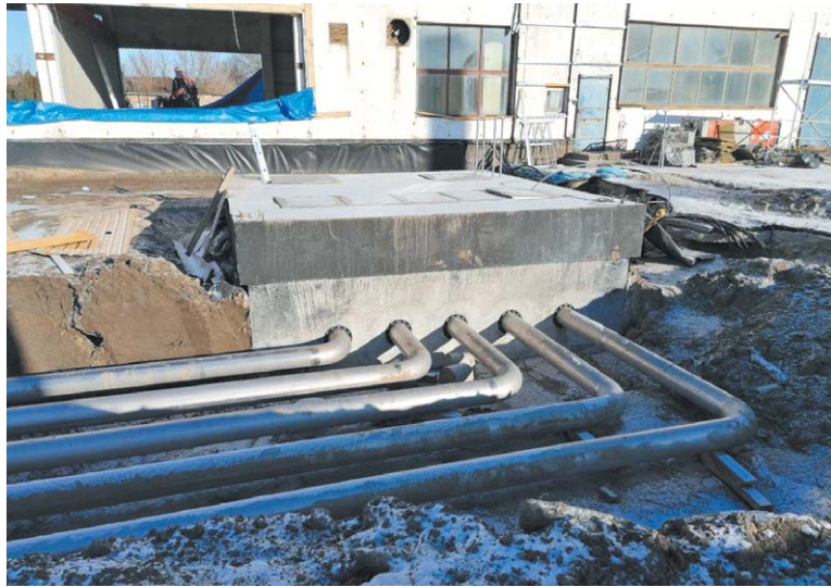
Pompownia główna na terenie oczyszczalni ścieków w Łukowie
