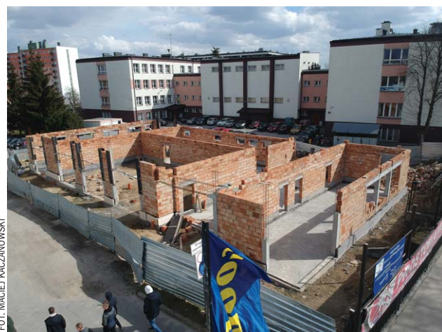
FOT. MACIEJ KACZANOWSKI Obiecana szkole przy ul. Popiełuszki stacja diagnostyczna powstanie z dwuletnim opóźnieniem. O ile uda się znaleźć jej wykonawcę
