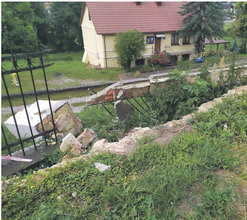
Zabytkowy mur zniszczony przez drzewa, osłabione fatalnymi cięciami koron
